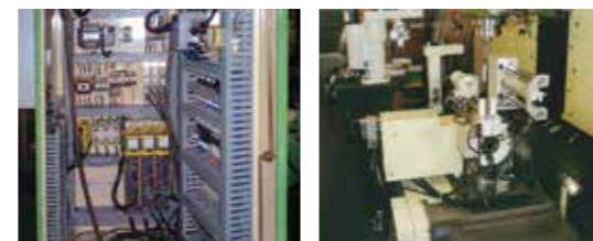
制御システム
